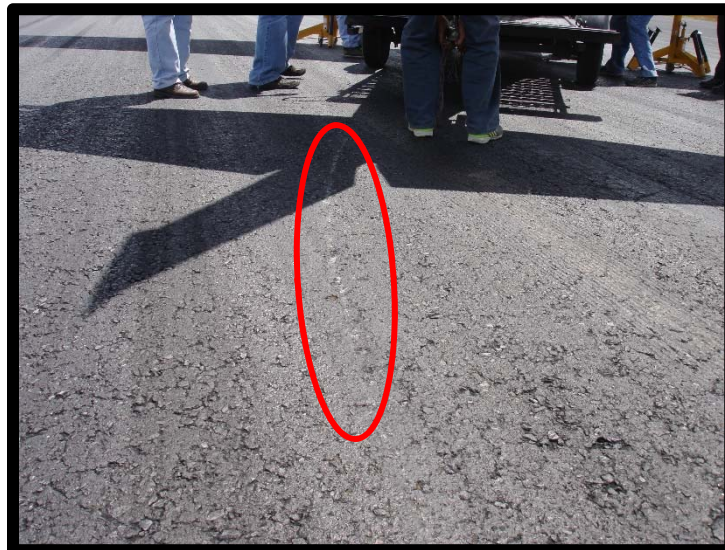
Fotografía No. 2 Marca dejada en el asfalto.
